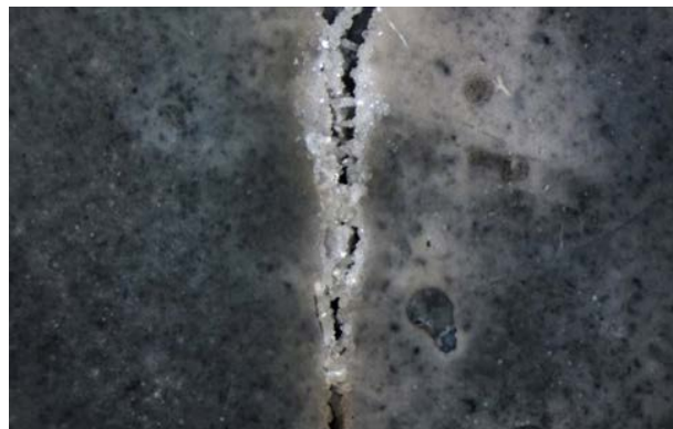
ترمیم ترک خوردگی در سازه بتنی با روش نانوسیمان زیستی
